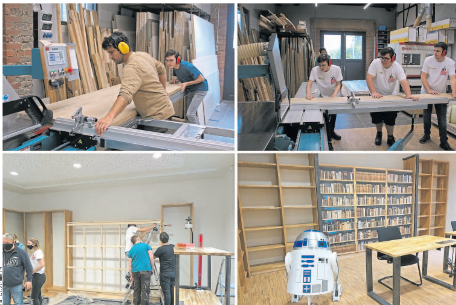
Einblicke in die Arbeiten rund um den Bau der neuen Schulbibliothek für das Technisch-Wissenschaftliche Gymnasium Dillingen (TWG), bei dem das Schülerteam mit der Seco Schreinerei aus Wadgassen zusammenarbeitete.
