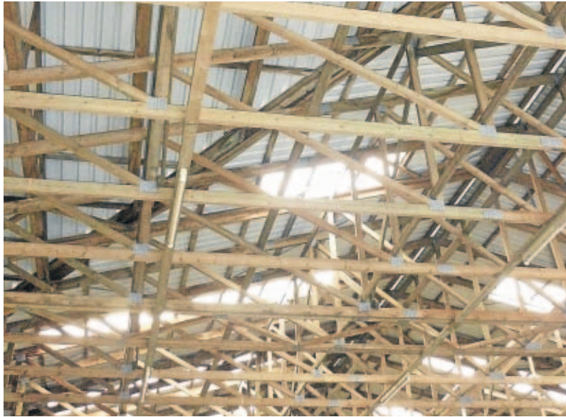
Sicherheit geht vor: Die Haltbarkeit harnstoffharzverklebter Holzbauteile ist Gegenstand der Untersuchung des Ministeriums für Inneres und Sport
