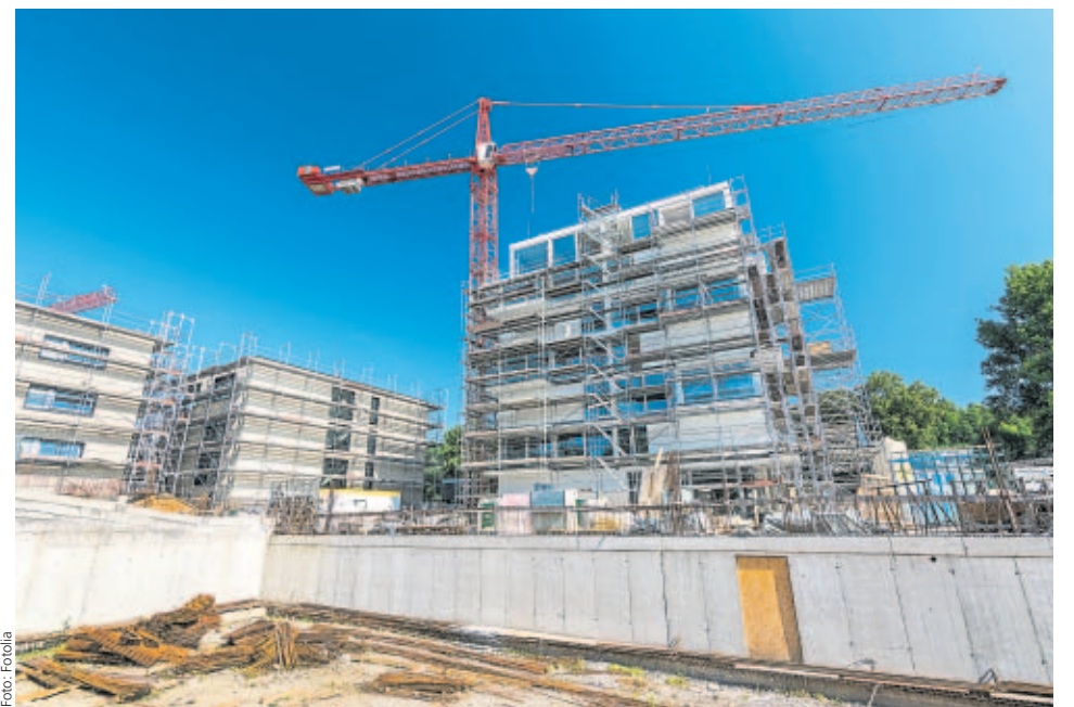
Die saarländische Baukonjunktur leidet auch unter Umsatzeinbußen im Hochbau. Grund ist die mangelnde Auftragslage beim öffentlichen Hochbau des Landes und der Kommunen.
